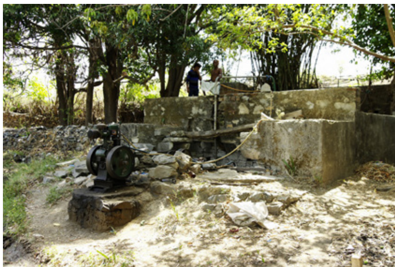
写真③インド北西部の井戸に設置されたエンジンポンプ
